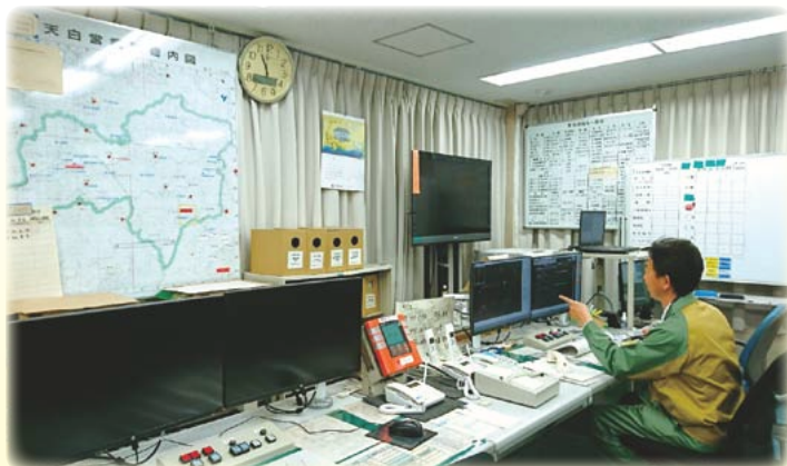
電気の流れについては集中監視しています。
